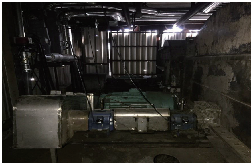
图1：位于顶棚设备室的排气风机，其经常面临夏季高达70°C的高温以及冬季严风寒雪的恶劣条件。
